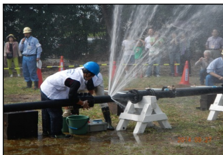
〈配水管の破裂状況〉
