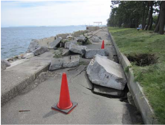
護岸上部工倒壊と陥没
