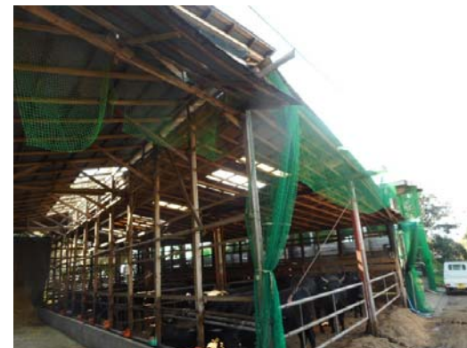
畜舎の屋根の破損
